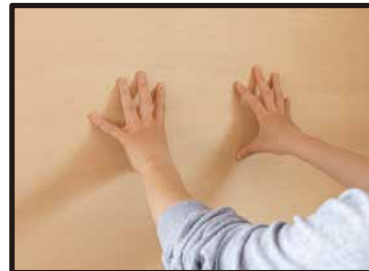
①下地を両手で押してみてもたわみや浮きがないか確認する。
